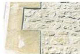
L'enduit aurait dû recouvrir les moellons et se raccorder exactement au niveau des encadrements en pierre de taille.
